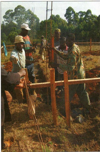
Die Arbeiten in Kamerun schreiten voran: Inzwischen sind die Fundamente gelegt (Foto) und die Mauern stehen schon. Foto: Weinhold
